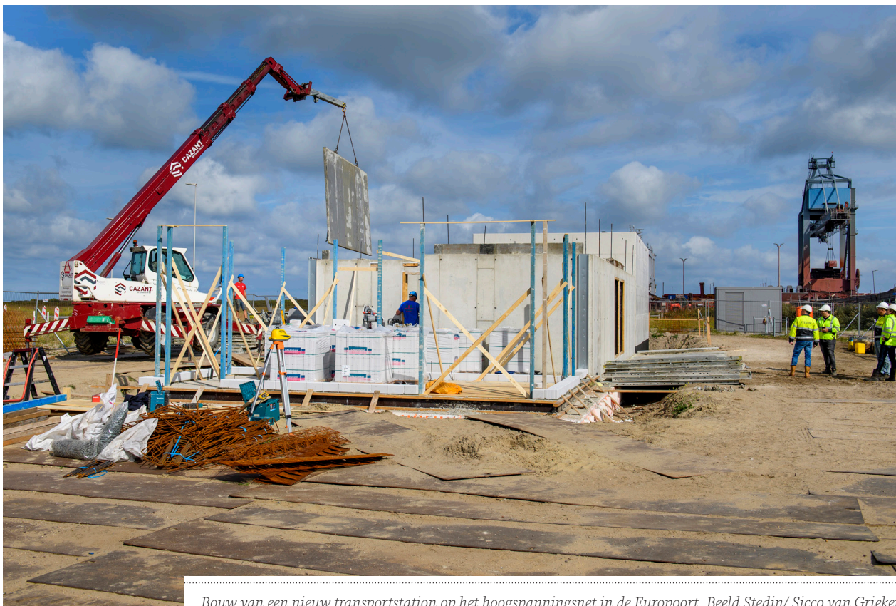
Bouw van een nieuw transportstation op het hoogspanningsnet in de Europoort. Beeld Stedin/ Sicco van Grieken
